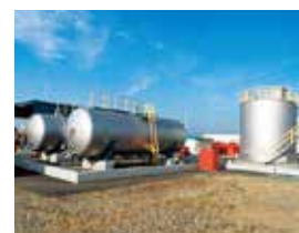
富山空港給油施設
