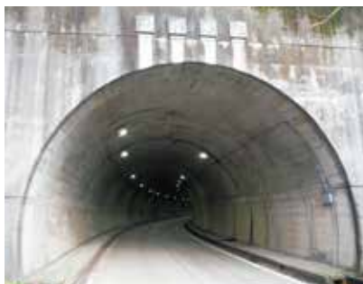
県道金沢井波線二俣トンネル照明設備
